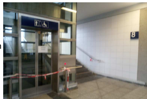
Abbildung: Ausgefallener Aufzug Gleis 7/8 Hbf Aschaffenburg
